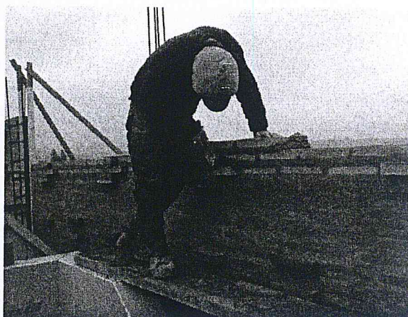
Foto N° 4. Falta de elementos de seguridad.
